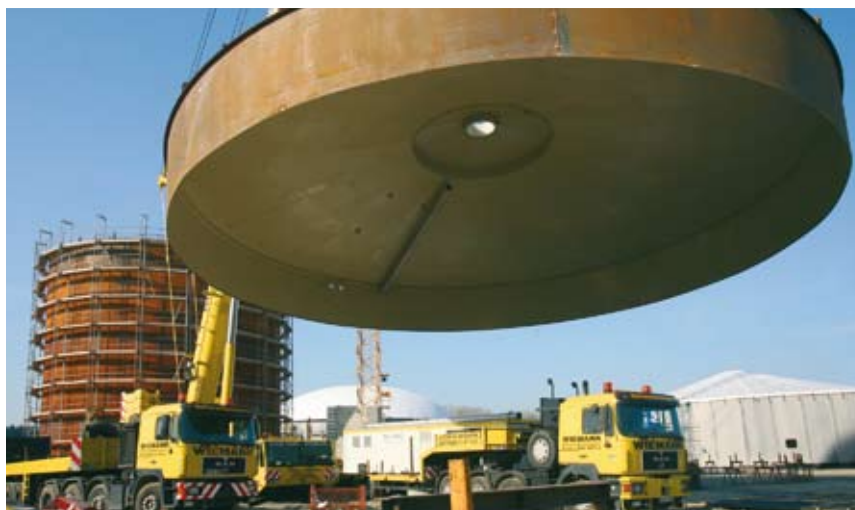
Биогазовая установка Хорн – Бад Майнберг
