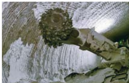
Эксплуатация AM75 под землёй
