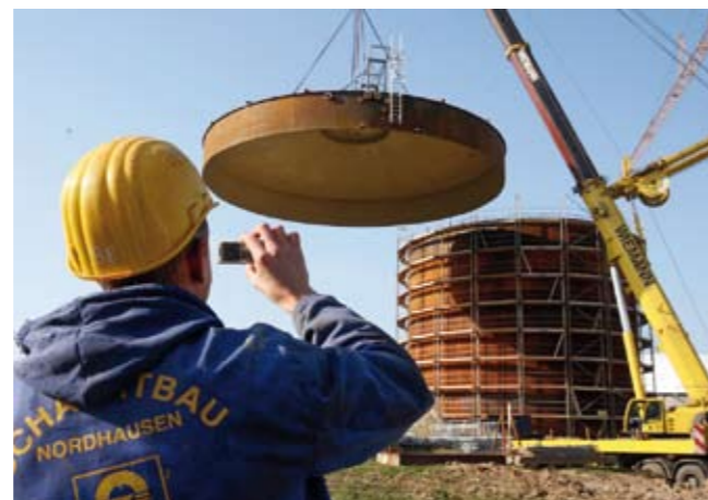
Biogasanlage Horn-Bad Meinberg (NRW)
